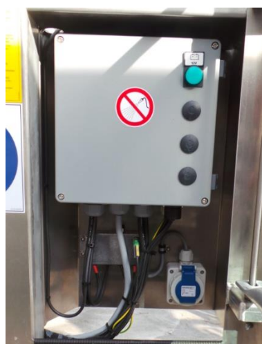
Abb. 5-12 Steuerschrank in der Arbeitsbühne
