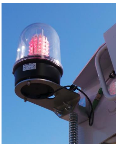
Abb. 10-40 Flughindernisleuchtung in betrieb
