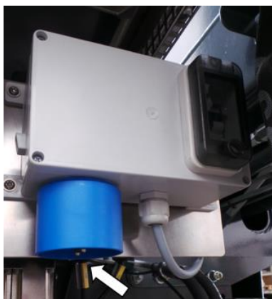
Abb. 11-1 Einspeisung für Steckdose 230 V (10A)
