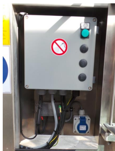
Abb. 5-9 Steuerschrank in der Arbeitsbühne
