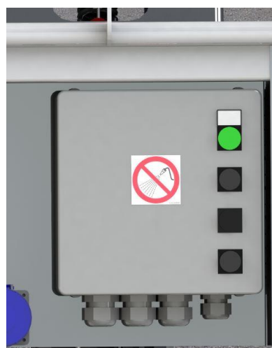
Abb. 5-12 Steuerschrank in der Arbeitsbühne
