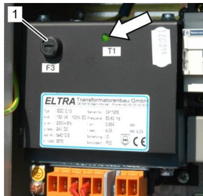
Abb. 239: Kontrollleuchte und Sicherung Netzteil
