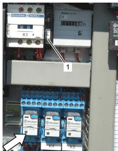
Abb. 240: Kontrollleuchte und Sicherung Elektromotor
